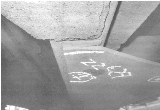
Рис. 3. Тріщина на з'єднанні нижнього листа хребтової балки
