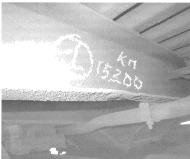
Рис. 4. Деформація нижньої полицки поперечної балки
