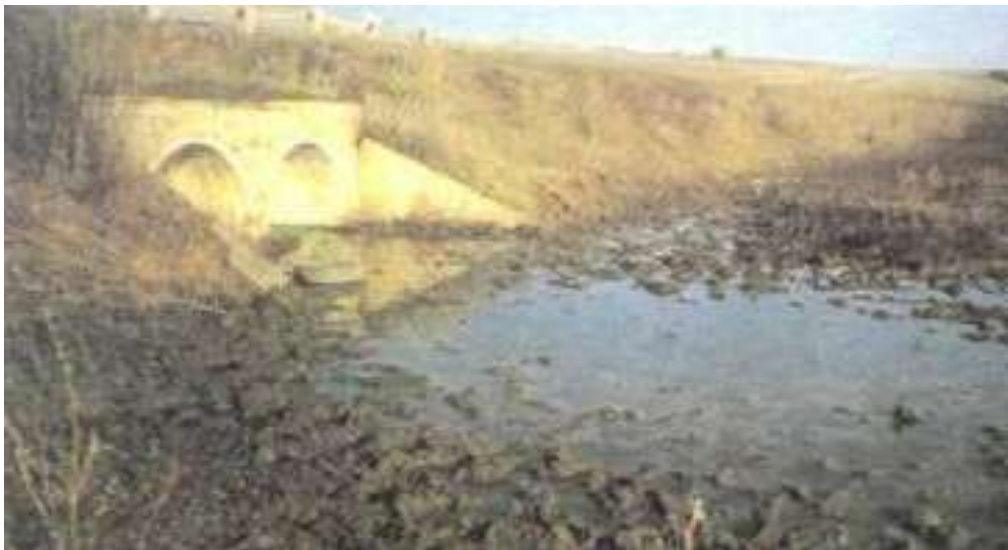
Рисунок 3.4 - Застій води у оголовків водопропускних труб
