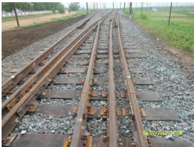
Рис. 5 – Сплетіння переводу стрілочного типу Р50 марки 1/11 колії 1435 мм з колією 1520 мм під час вкладки
